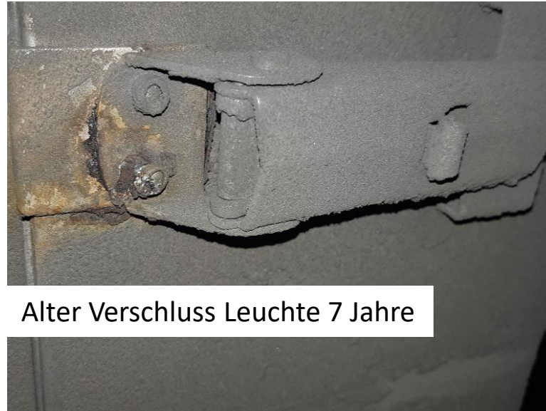
Spalt- und Spannungsrissskorrosion (CRC III)
