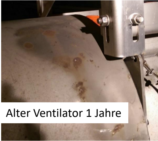
Lochkorrosion an Bauteiloberflächen – mannigfaltige Ursachen
